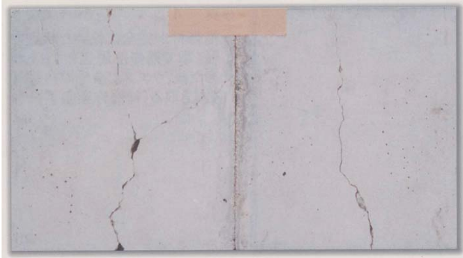
写真 - 1 補修前のクラック状況
